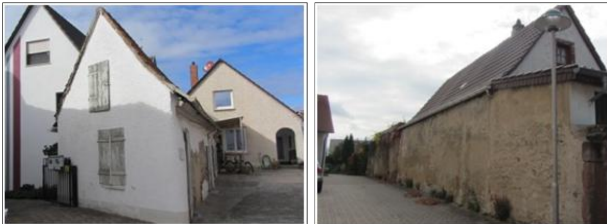
Abbildung: Renovierungs- und sanierungsbedürftige Bausubstanz Quelle: Eigene Fotografien
